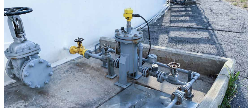
ระบบระบายน้ำอัดโนมิติที่ถังเก็บ
